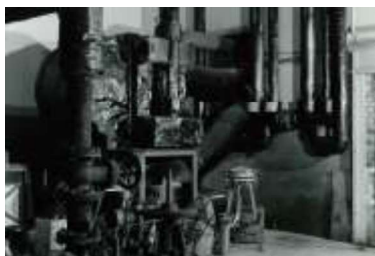
A 棟 1 階・冷却室/ブレインタンク
