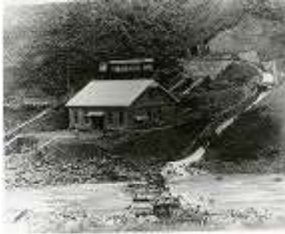
写真 i-9.建設中の岩木川福島発電所 [撮影年：1921年（大正10年）～1923年（大正12年）頃/青森県立郷土館蔵]
