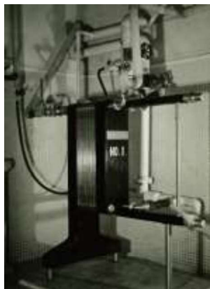
A 棟 1 階・濾過室/冷却器
