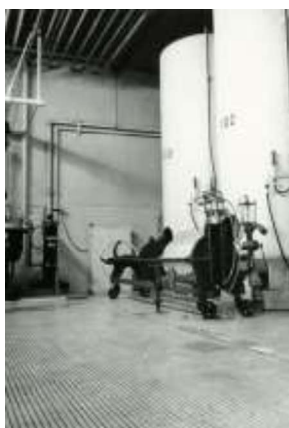
A 棟 1 階・濾過室/冷却器
