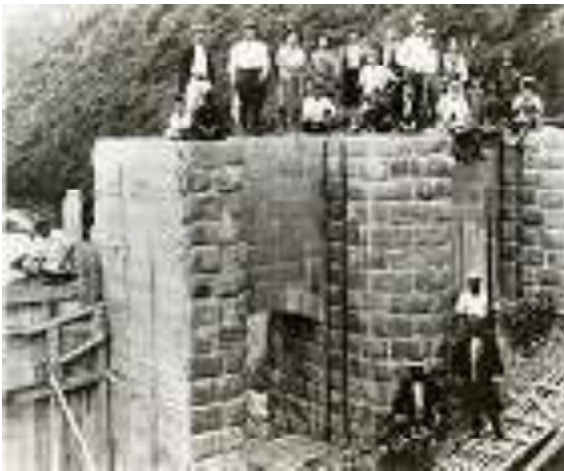
写真 i-13.建設中の岩木川福島発電所 [撮影年：1921年（大正10年）～1923年（大正12年）頃/青森県立郷土館蔵]
