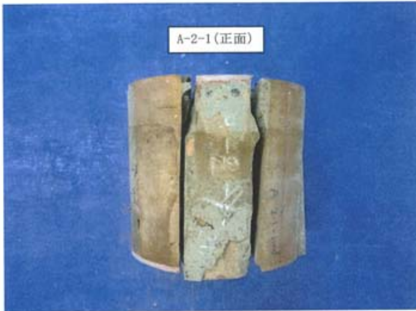
写真-63 目地モルタルの破壊状況 (正面) [A-2-1]
