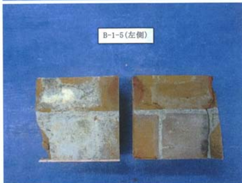
写真-85 目地モルタルの破壊状況 (写真-84 左側) [B-1-5]
