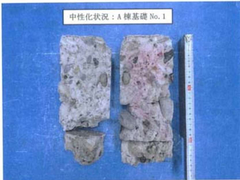
写真-4 中 性 化 状 況 [A棟基礎No. 1]
