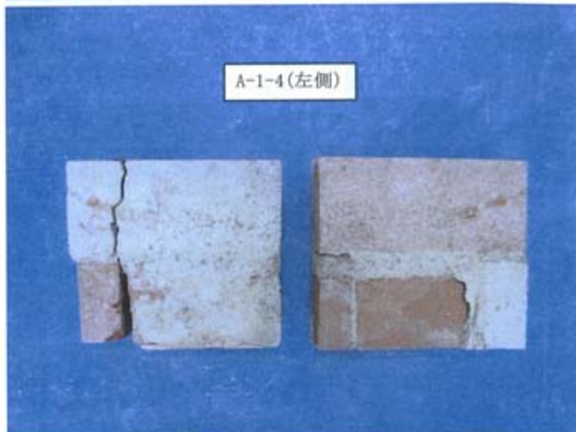
写真-58 目地モルタルの破壊状況 (写真-57 左側)[A-1-4]
