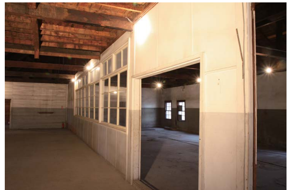
A棟 2階中央壁
