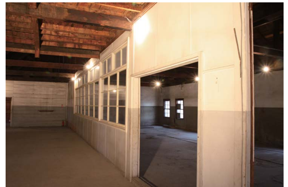
A棟 2階中央壁
