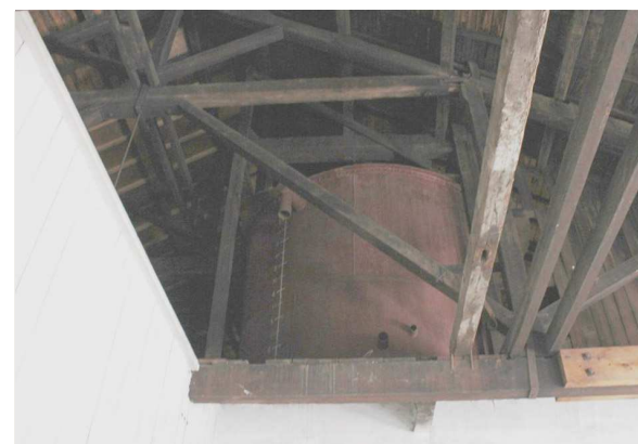
屋根裏 防火水槽（樽）
