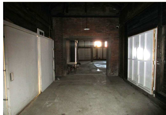
前室 ・改修もしくは、解体を提案してよい。その際法定的に準耐火建築物（ロー1）とする事が求められる（資料8参照のこと）。
