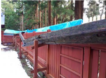
積雪により屋根が毀損するなど老朽化が著しかった。
