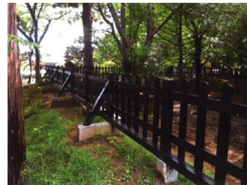
傷みのある箇所を部材を取り替え、古色塗りをを行ったことにより、史跡景観の向上が図られた。竣工：平成30年7月24日
