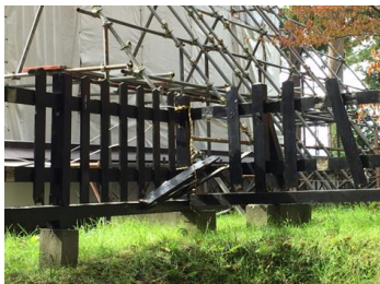
木塀及び門の割れや基礎部分の沈み等が見受けられ、史跡景観を損ねていた。
