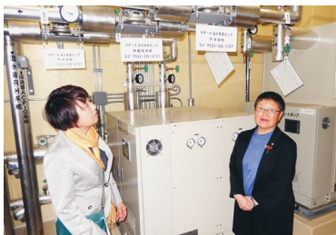
旭川市東部まちづくりセンター内にある地中熱冷暖房システム
