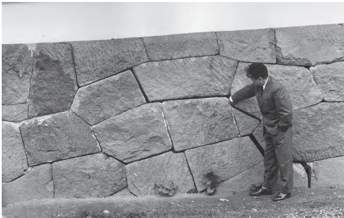
図版 3 天守台石垣北側の目地の開き（昭和 43 年（1968）撮影）北から
