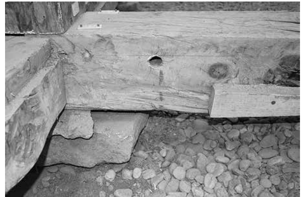
⑥天守土台角材の側面に入る貫通孔 西から
