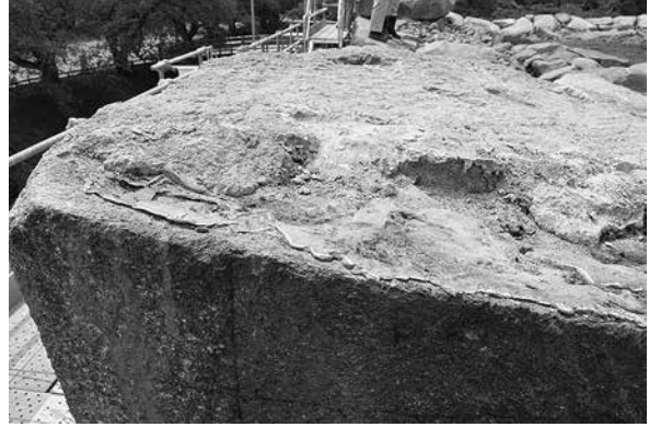
④イニ角-2 上面溶けた鉛確認状況(北から)
