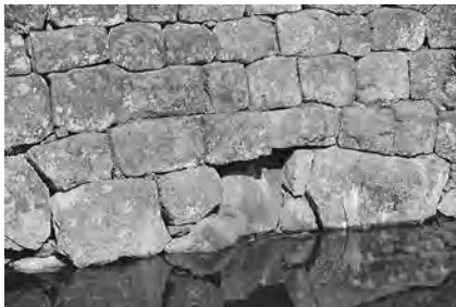
本丸東面 水面際の築石の破損状況
