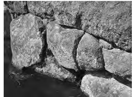
本丸東面 水面際の築石の割損状況
