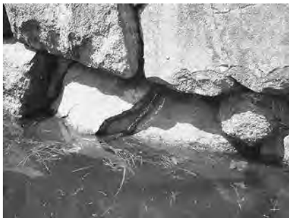
本丸東面 水面際の築石の割損状況
