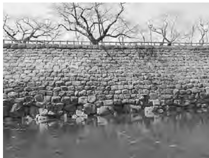
本丸東面 孕み及び水面際の築石の破損状況
