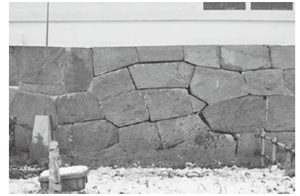
天守台北面 目地の開き状況
