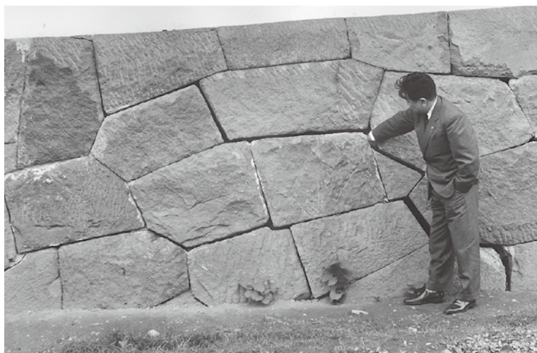
図版 3 天守台北面石垣の開き 昭和43年(1968)撮影
