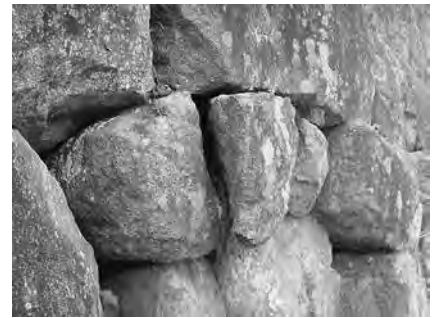
本丸東面 築石の割損状況(前後破断)
