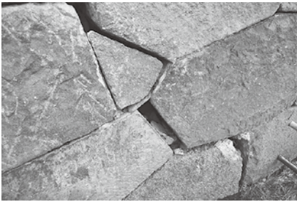
天守台北面 目地の開き状況
