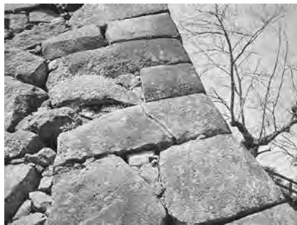
本丸東面 右方出角部の角石の割れ状況
