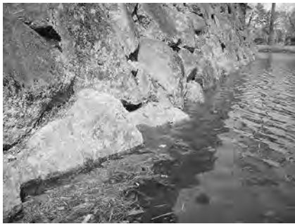
本丸東面 水面際の築石の迫り出し状況
