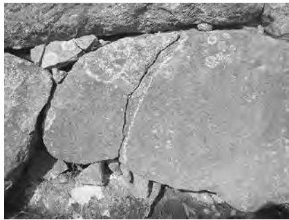
本丸東面 水面際の築石の割損状況
