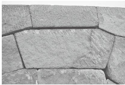
天守台北面 目地の開き状況
