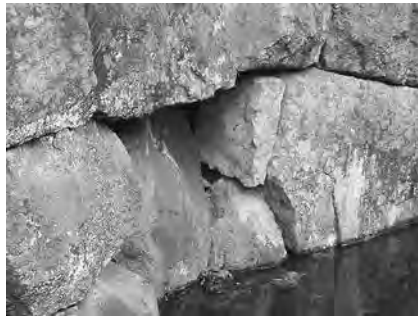
本丸東面 水面際の築石の破損状況
