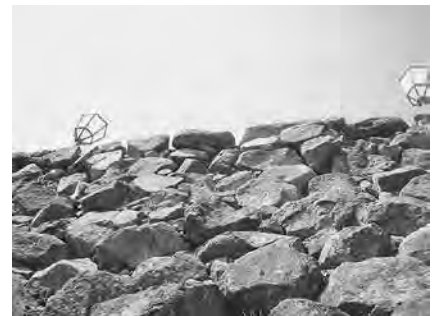
本丸東面 天端石の迫り出し状況
