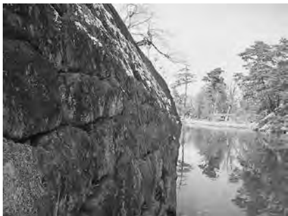
本丸東面 孕み状況
