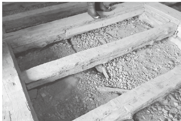
天守台表面の亀裂（C区）南西から
