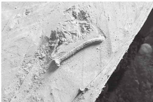
床梁・根太に打ち込まれた洋釘
