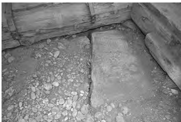
A区北東隅亀裂（南から）
