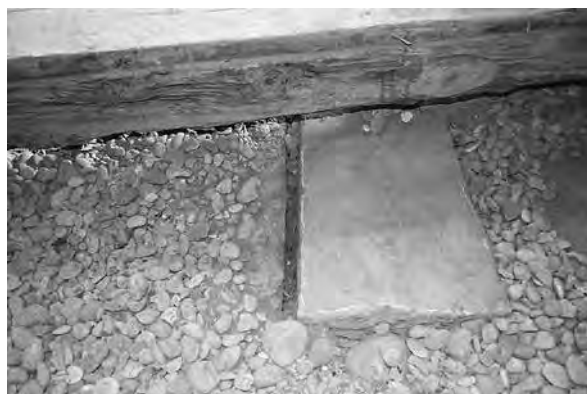
A区南西隅亀裂（北から）
