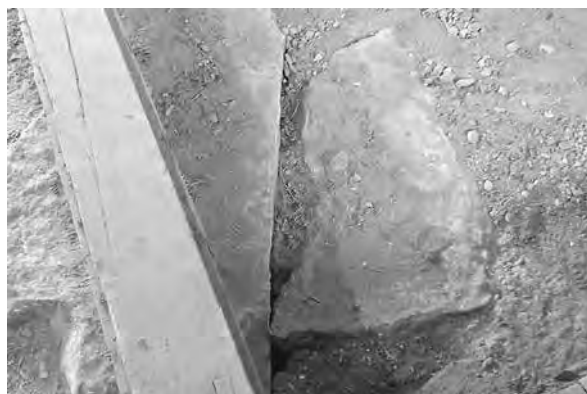
B区空隙（深さ14cm）東から
