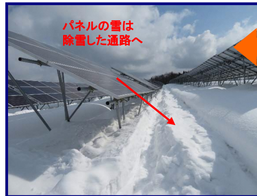
⑤除雪した通路に、パネルの雪が滑り落ちる事でパネルが露出します。 雪が積もる冬でも、発電可能となります。
