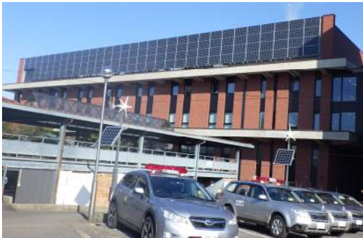
市役所屋上に設置してある太陽光パネル
