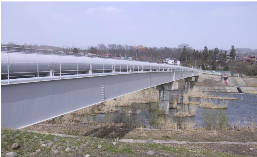
津軽広域水道企業団の水管橋
