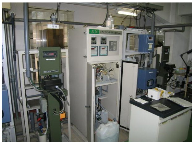
樋の口浄水場の自動水質監視機器
