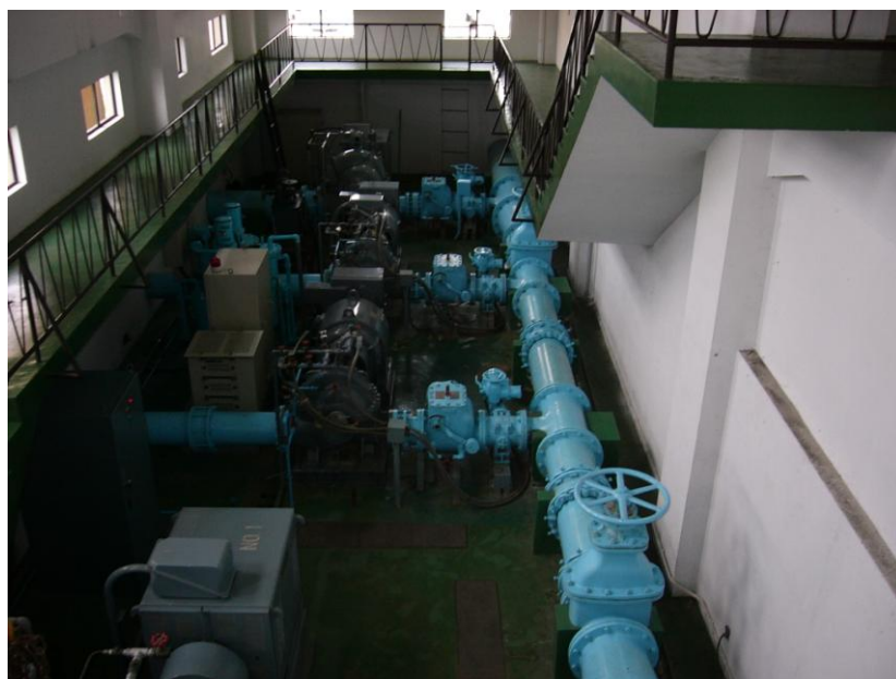
樋の口浄水場送水ポンプ
