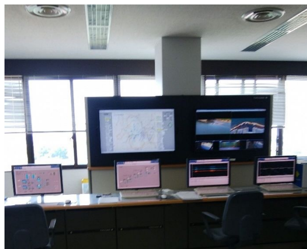
中央監視装置
