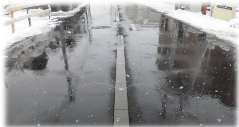
【 豊田地区の散水消雪施設 】
