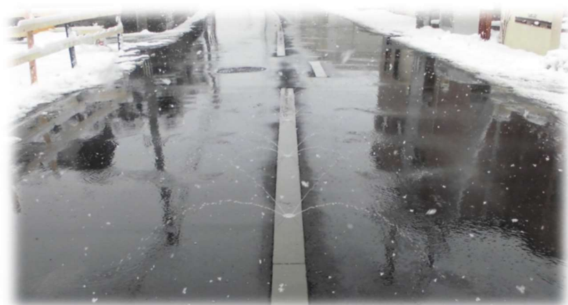
【 豊田地区の散水消雪施設 】
