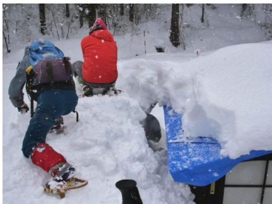
作業小屋の屋根雪が落雪と繋がっていた
