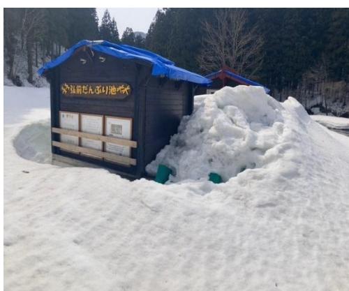
作業小屋落雪状況
