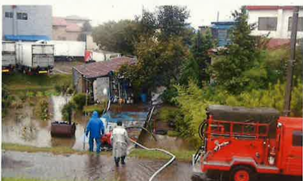
内水排除状況（市内大久保地区）
