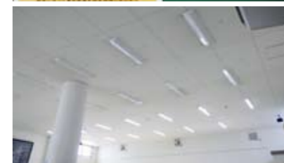
毎月の電力使用量を知らせる掲示(上) / 省エネルギーを考慮した照明(下)
