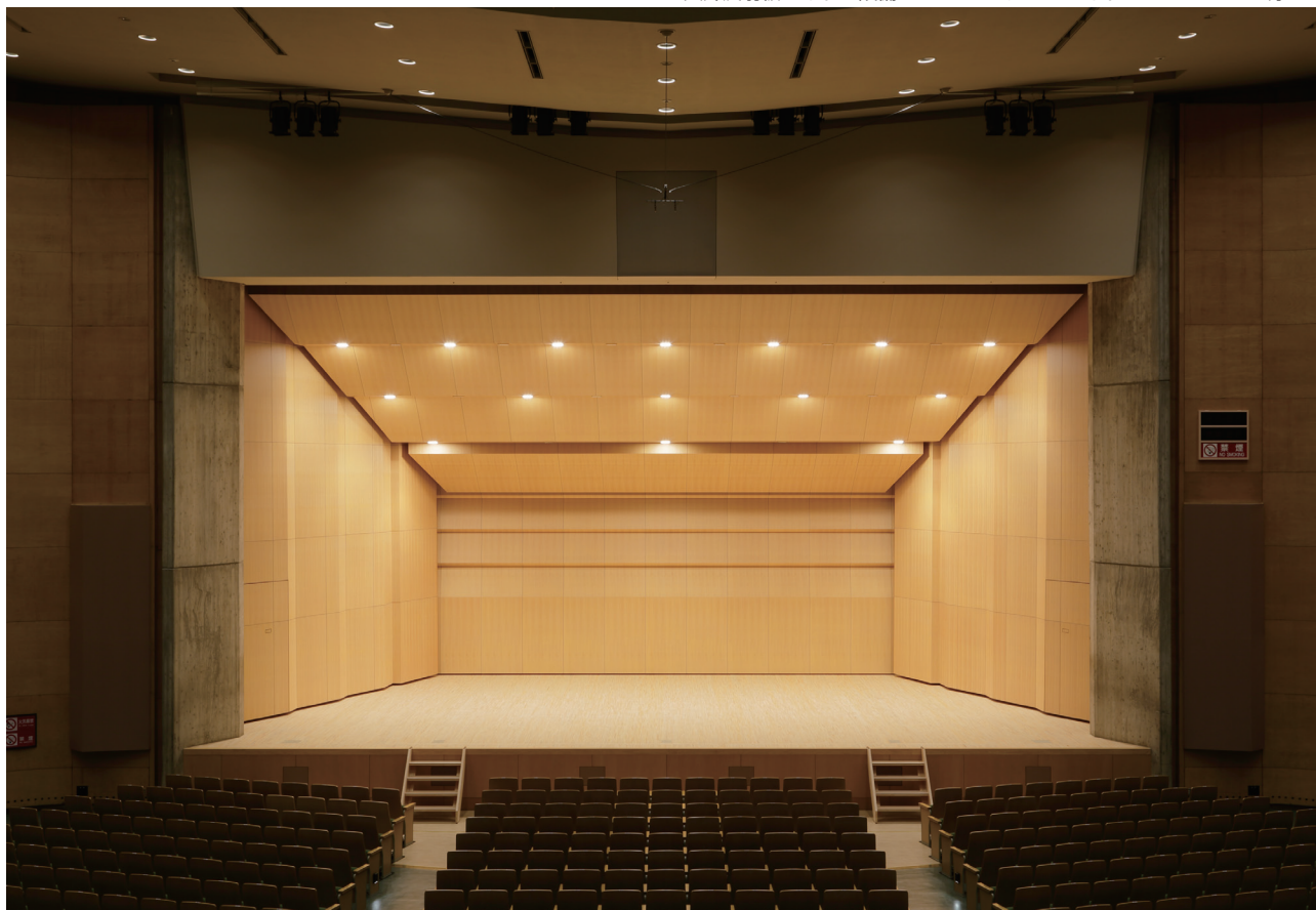
天井反射板ライトに設備された LED ダウンライト DDL 型 WW の明かり
