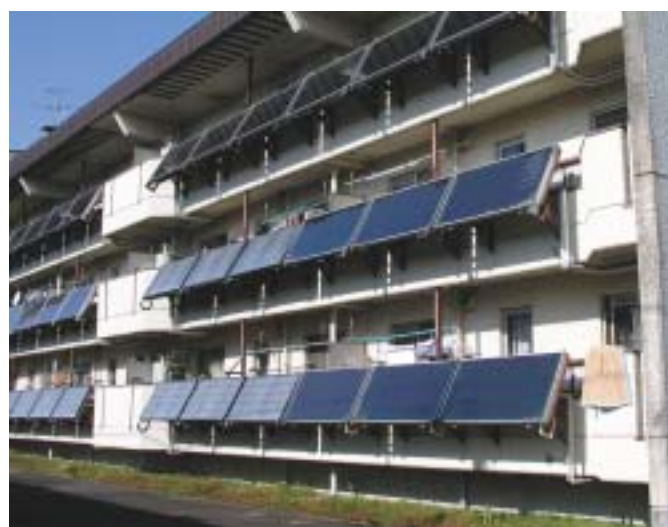
太陽光を利用したソーラーシステム
